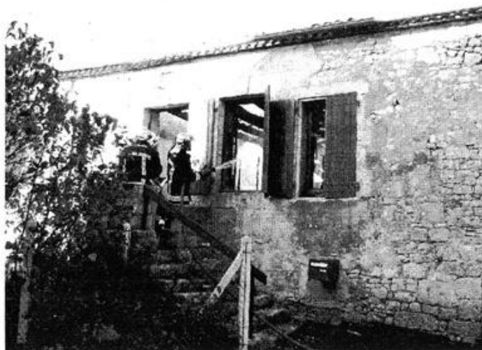
Du pavillon il ne reste que les murs en pierre. Les pompiers ont passé tout l'après-midi à déblayer jusqu'à ce qu'il ne reste plus une braise
